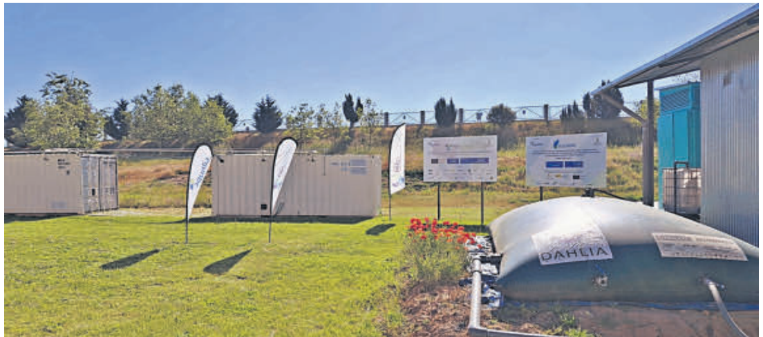
Planta demostrativa para tratamiento de fangos y producción de biometano en el Centro de Innovación en el Ciclo Integral del Agua (EDAR Salamanca).
